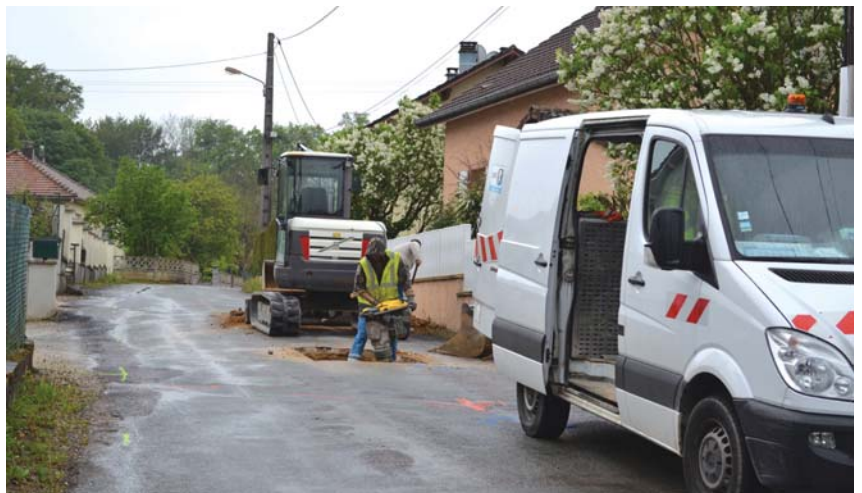
Les premiers coups de pelle rue des Minerais : deux mois de travaux seront nécessaires pour mener à bien ce chantier, la rue fera ensuite l'objet d'une réfection complète.
