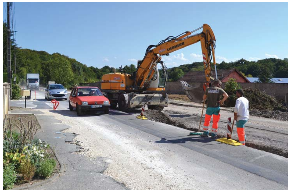
Les importants travaux de voirie nécessitent la mise en place d'une circulation alternée réglée par des feux tricolores.
